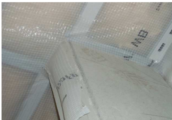
Obrázek 106 Nesprávně provedená hlavní vzduchotěsnící vrstva u vnitřní příčky.
