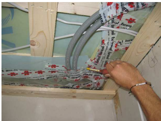
Obrázek 92 Únik do stropní konstrukce.
