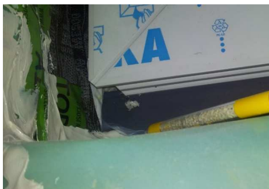
Obrázek 63 Nedotěsněný roh okna.
