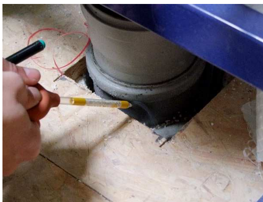
Obrázek 99 Nedotěsněné odpadní potrubí.
