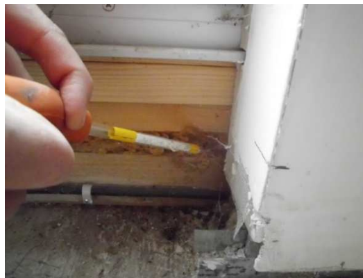
Obrázek 65 Degradovaná PUR pěna po 2 letech užívání konstrukce.
