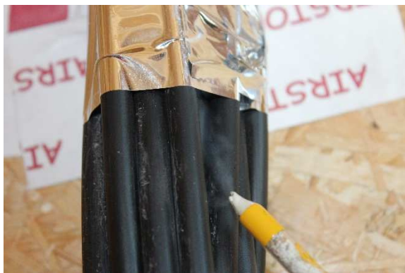
Obrázek 98 Neutěsnitelný detail svazku kabelů.
