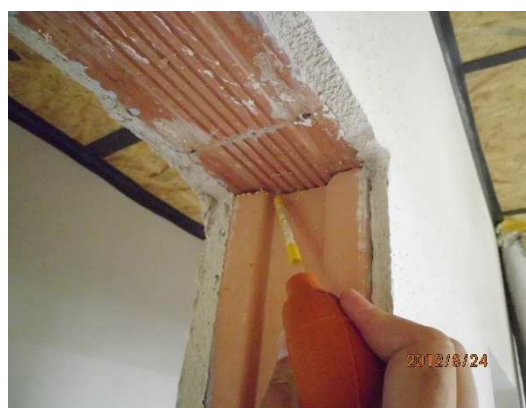
Obrázek 109 Neomítnutý otvor pro interiérové dveře.
