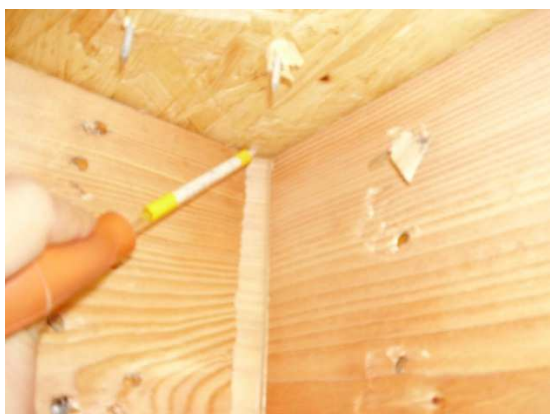
Obrázek 90 Nekvalitní polepení stropní konstrukce.
