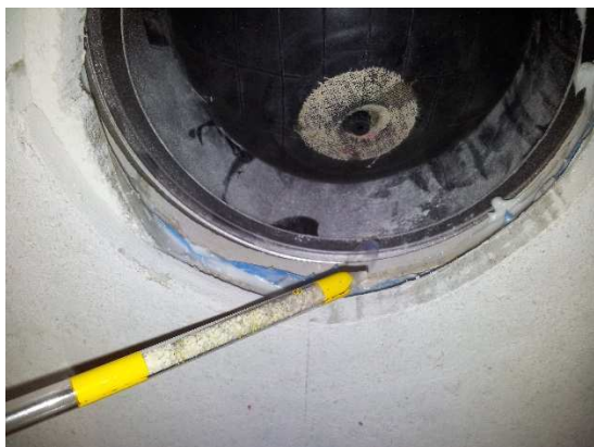
Obrázek 102 Únik vzduchu do pláště komínu.
